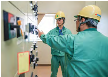
▲設備運転操作
