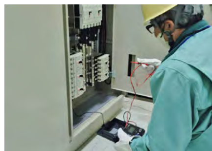
▲建物設備管理(電気設備点検)
