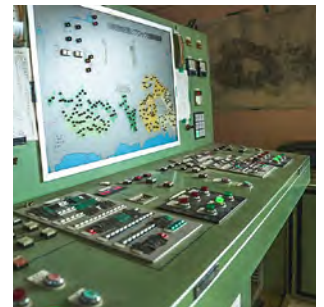
▲畑地灌漑設備制御室
