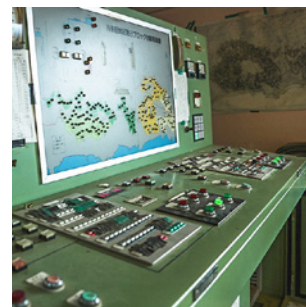
▲畑地灌漑設備制御室
