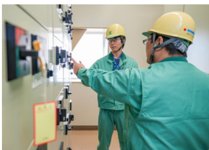
▲設備運転操作
